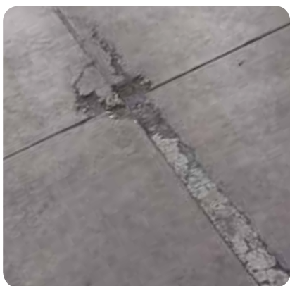
Разрушение деформационных швов
