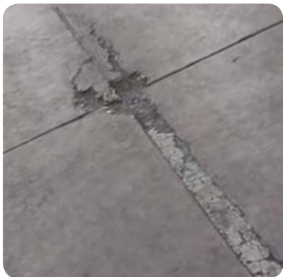
Разрушение деформационных швов
